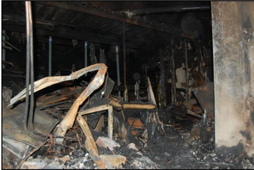
Figur 12 visar skador i sportbutiken, sett från korridoren. Källa RSG
