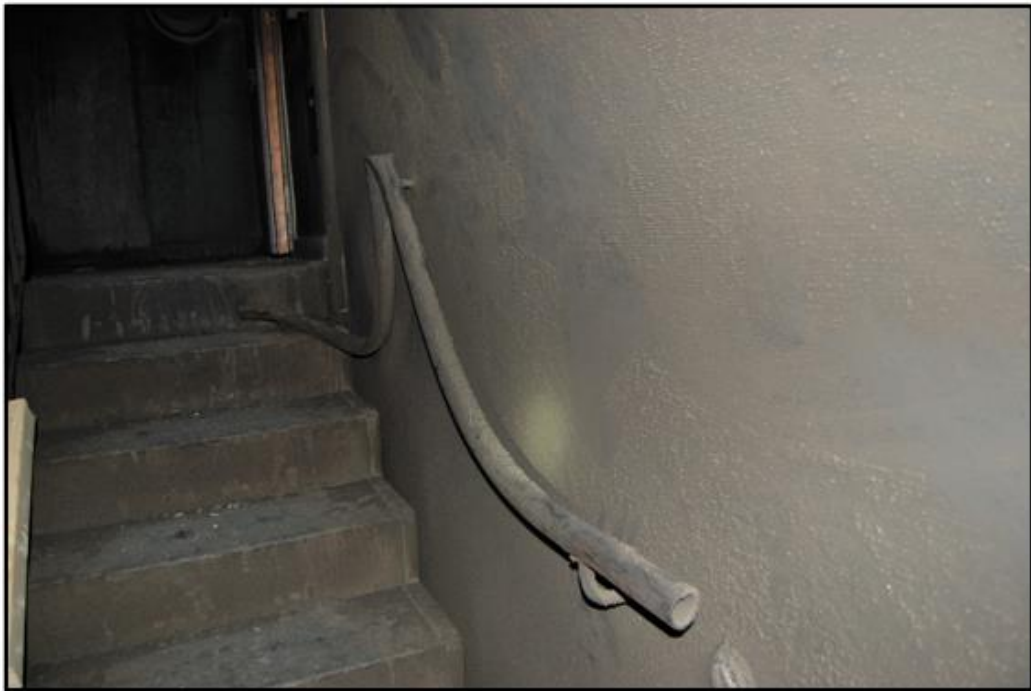
Figur 18 visar värmepåverkat trappträcke i trapphus 22. Källa RSG
