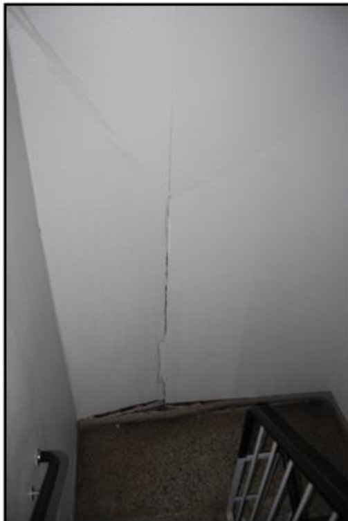
Figur 13 visar skadad vägg. Källa RSG
