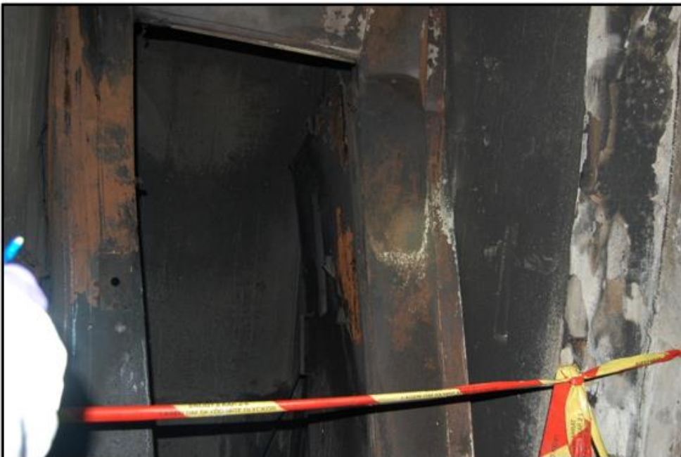
Figur 15 visar hissdörr plan -2 som är intryckt i hisschaktet. Källa RSG
