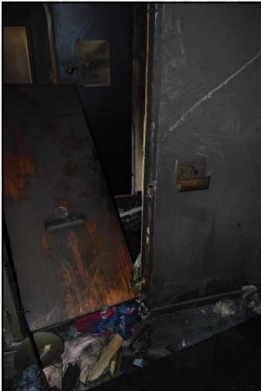
Figur 17 visar intryckt lägenhetsdörr i trapphus 22. Källa RSG
